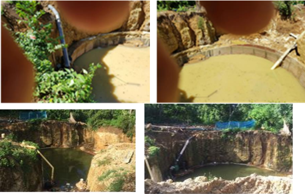
Construcción estación de bombeo No.4 descargue de concreto en pared y fondo
